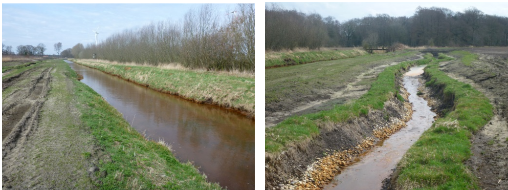
Afbeelding 6: Aanleg van een halfnatuurlijke nevengeul langs de Melstruper Beeke bij Lathen in de Landkreis Emsland (links: oude bedding, die behouden blijft voor de hoogwaterafvoer; rechts: nevengeul kort na de aanleg) (Bron: NLWKN)
